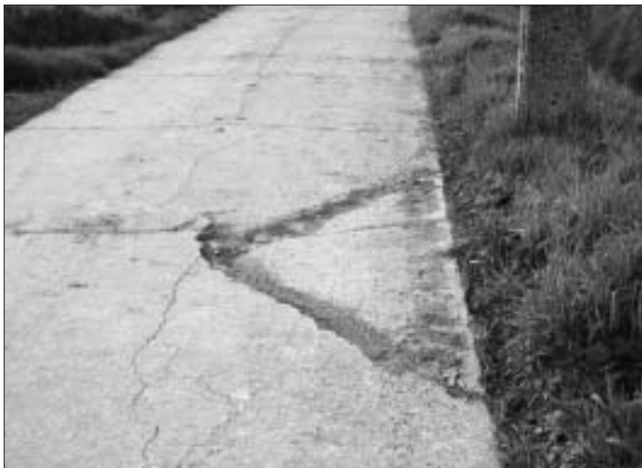
Een bewonersplatform meldt het stadsbestuur 'ernstige schade' aan het wegdek.
